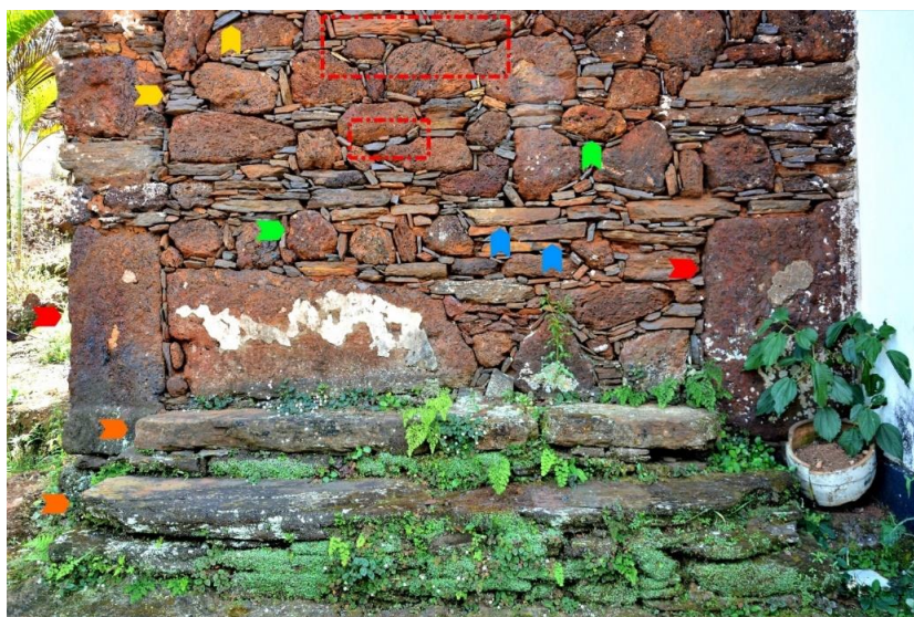
Figura 1 – Trecho de parede da capela-mor, Capela de Nossa Senhora da Conceição, Distrito de Passagem, Mariana
