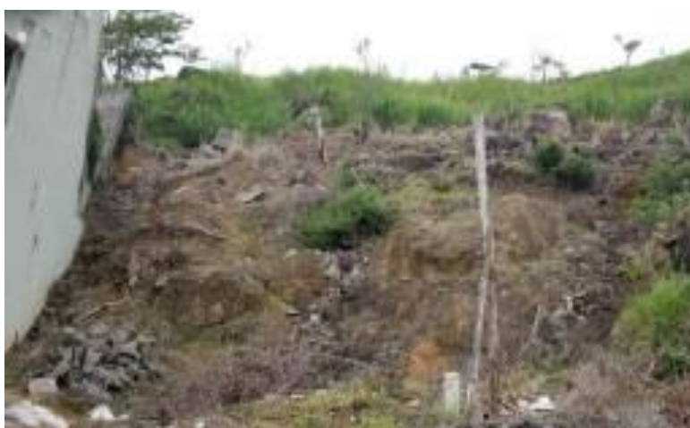
Figura 8 – Cicatriz de escorregamento na zona de ocupação restrita (ZOR), com presença de blocos, ao lado de uma residência (acervo da autora).
