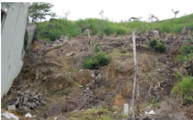
Figura 8 – Cicatriz de escorregamento na zona de ocupação restrita (ZOR), com presença de blocos, ao lado de uma residência (acervo da autora).
