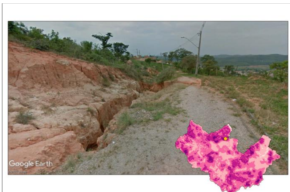
Figura 4. Feição erosiva no bairro Barcelona, Ribeirão das Neves, MG.
