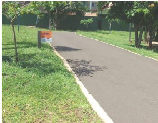
FIGURA 6 – Desnível na ligação do acesso principal ao secundário em 17 de maio de 2010.
