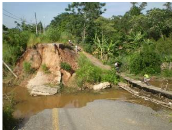
FIGURA 3: Estragos causados por enchente no Rio Paraíba do Sul Lorena – SP. Fonte: Gonçalves Junior (2010).
