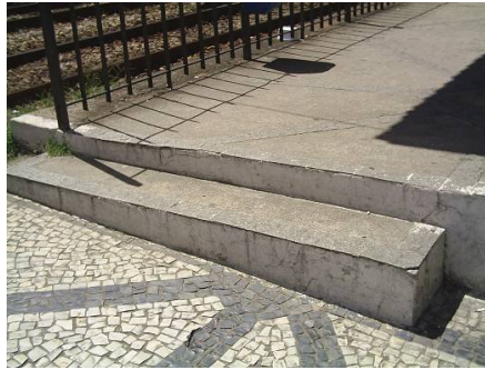
FIGURA 22: Degrau na Estação Ferroviária Fonte: Arquivo pessoal, 2008.
