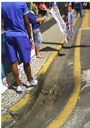
FIGURA 27: Inexistência de uma rampa para saída Fonte: Arquivo pessoal, 2008
