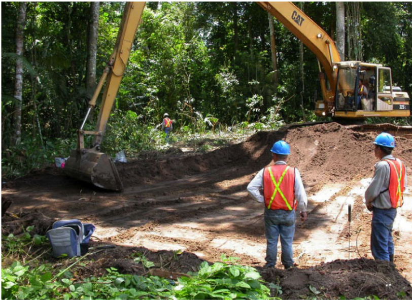
Excavación por decapado de gran superficie del sitio de Surnaukreek, Suriname, en 2004, en el marco del proyecto “Prehistoria del litoral occidental de Guyana” (foto S. Rostain)
