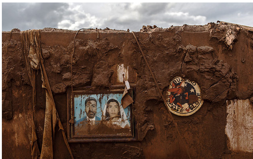
Imagem 05 - Detalhe de parede de domicílio em ruínas. Bento Rodrigues, Mariana – MG.
