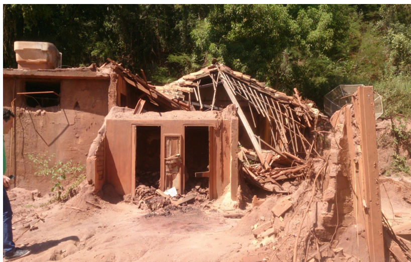
Imagem 03 - Ruína de edificação no povoado de Gesteira (Barra Longa – MG)
