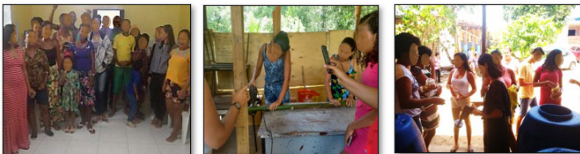
Figura 6. A participação da comunidade do Iguape nas etapas da construção da Fossa Séptica Ecológica
