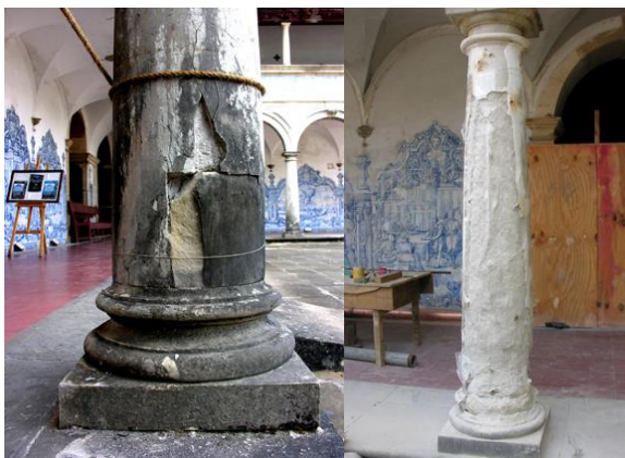
Figura 8. Estado de uma das colunas do claustro. a) Estado original; b) Removida a reintegração de cimento, sem aderência.
