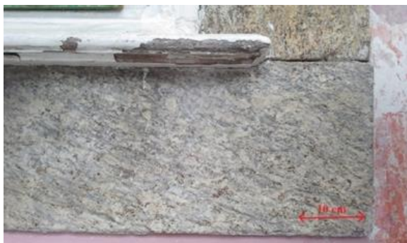
Figura 3. Rocha da Janela SP4 da fachada sul.
