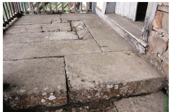
Figura 1. Trabalhos de cantaria na escada e varanda da sede da Fazenda Ribeirão das Rosas no município de Juiz de Fora, MG, 1751. Fonte: acervo fotográfico Ricardo De Cristofaro.
