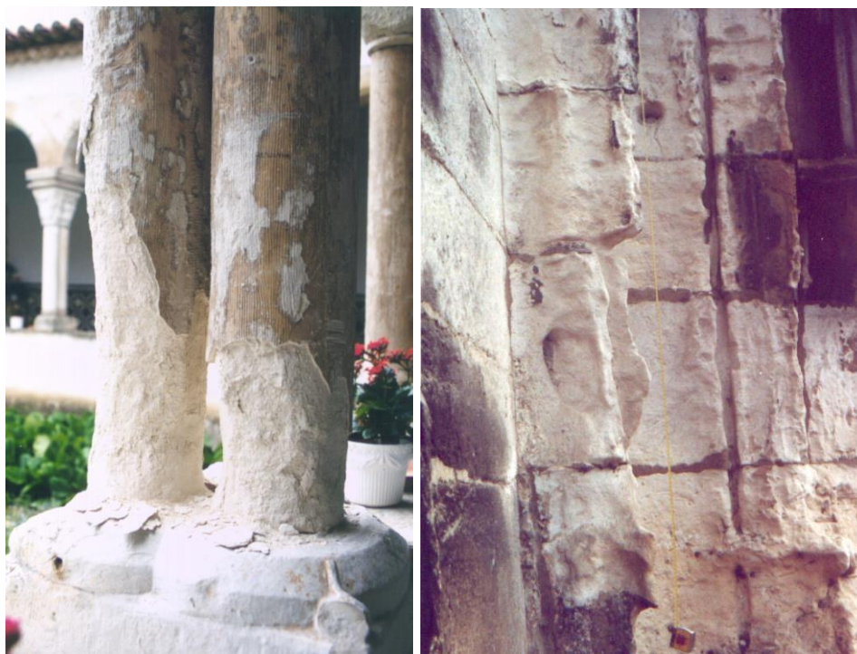
Figura 2. Aspectos da deterioração da Pedra de Anã em monumentos da cidade de Coimbra (Portugal).
