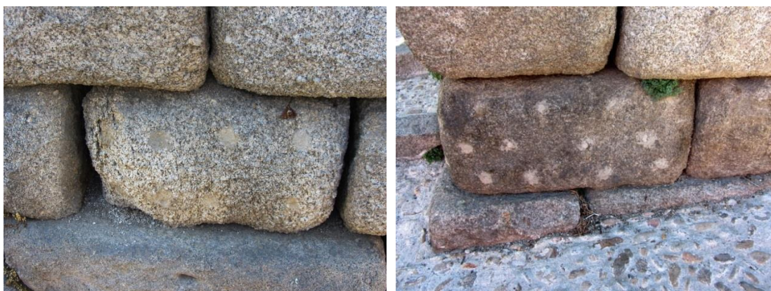
Figura 4. Blocos de granito com sinais de furos de injeção profunda para consolidação com resina epoxídica. A figura da esquerda mostra que a erosão continua e que a injeção não teve qualquer acção, como seria de esperar. A figura da direita mostra que o bloco tratado ainda estava longe do estado de alteração e do grau de arredondamento de muitos dos blocos não tratados, pelo que se podem levantar dúvidas sobre o critério usado na selecção dos blocos a tratar. Uma análise baseada nos pressupostos acima anunciados teria seguramente conduzido a outra solução de tratamento e a outro critério de selecção dos blocos a tratar.
