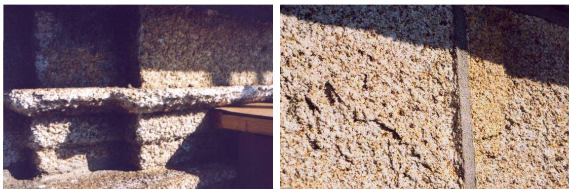
Figura 2. Exemplos de arenização em blocos de granito na igreja do Mosteiro de Tibães. Esta deterioração extrema demonstra uma alta taxa de alterabilidade, o que só pode ser explicado pela alteração adquirida durante a fase pré-extracção (alteração herdada).
