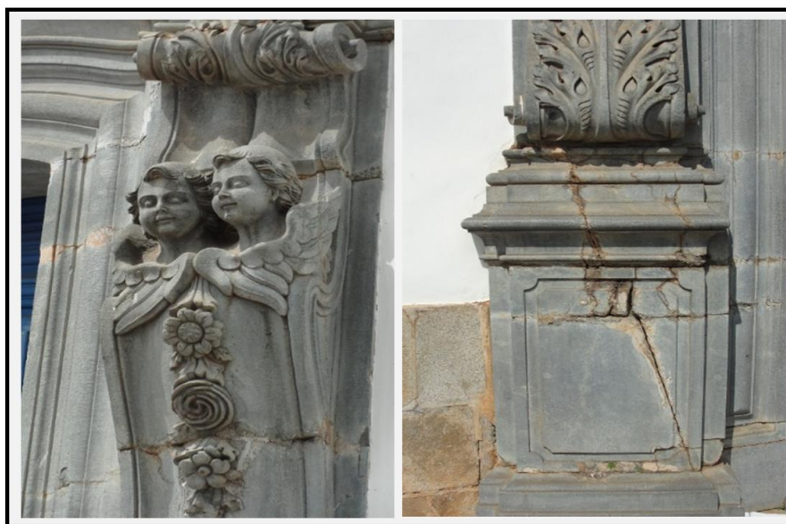
Figura 2. Portada com presença de esteatito maciço, mostrando granulação fina e coloração cinza escura. Notar fissuras na base esquerda da portada causadas possivelmente por compressão (fotografias - Neves 2016).
