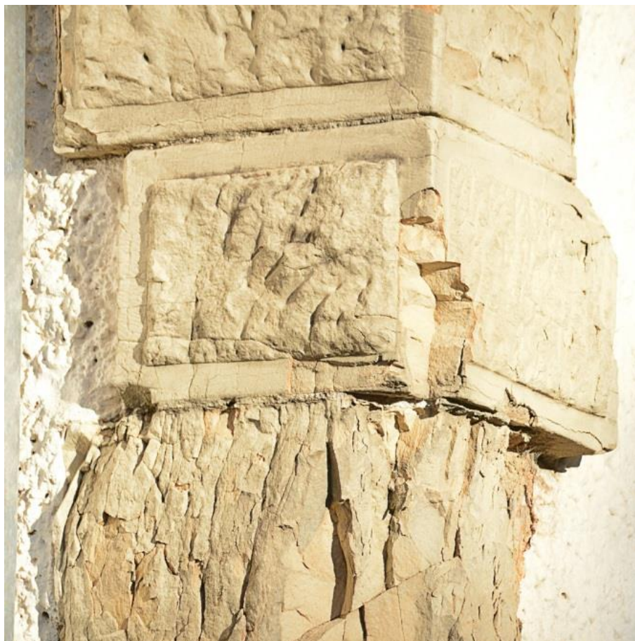
Figura 5. Cunhal de arenito da antiga estação (hoje Casa da Memória de Ponta Grossa) danificado. A necessária substituição envolverá o uso de rochas procedentes da mesma fonte e a técnica de cantaria semelhante ao original. Foto: Liccardo.
