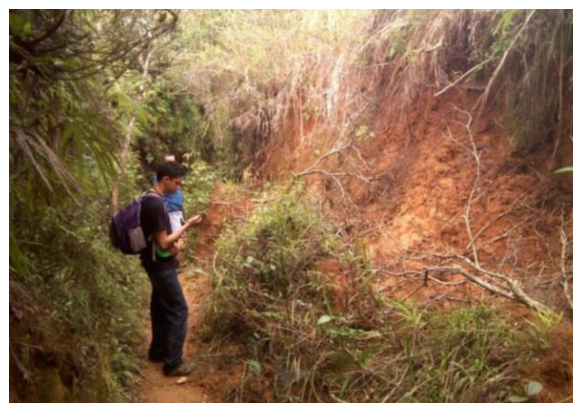
Figura 3. Detalhe do trecho correspondente ao ponto 3 com taludes instáveis ao longo da trilha.
