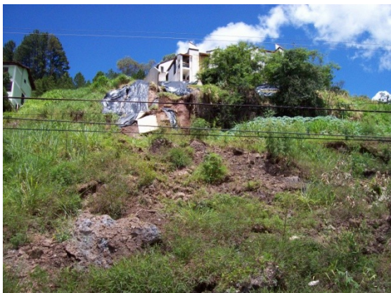
Figura 2 - Escorregamento em talude do bairro Mangabeiras, Belo Horizonte. A casa no topo está com estrutura abalada. Foto de 2012
