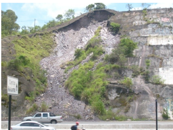
Figura 3 - Escorregamento em talude da BR040 criando situação de perigo. Foto de 2011
