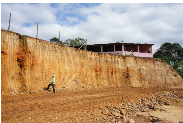
Foto 4 – Solo exposto, com processo de ravinamento, devido ao alto ângulo de corte.
