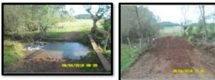
Foto 2: Antes e depois da instalação de ponte para passagem de animais e máquinas Fonte: SUTRAF-AU, 2016.
