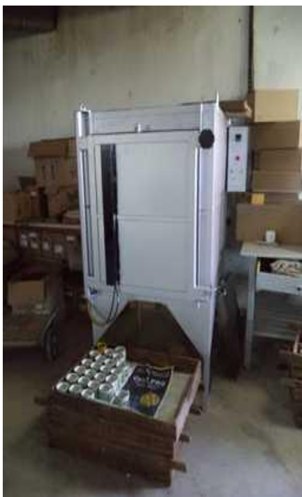
Imagem 15: Forno elétrico para a queima das peças na Cerâmicas São Joaquim. Foto: [suprimido], 24/01/2014
