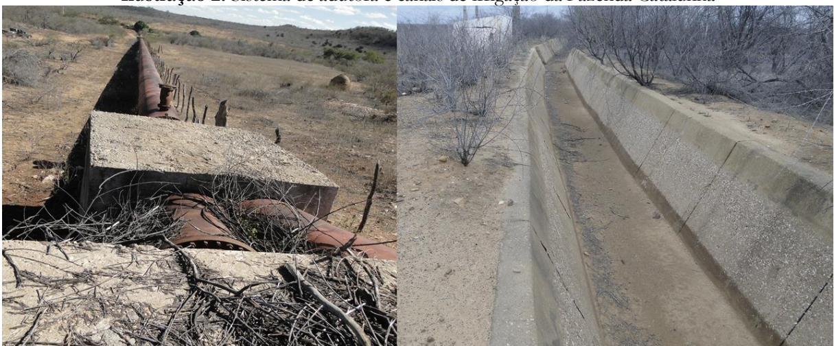
Ilustração 2: Sistema de adutora e canais de irrigação da Fazenda Catalunha
