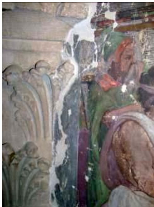
15. Fissuras devidas ao movimento de ajuste estrutural do edifício. Foto U.I.A..
