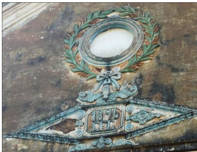
Figura 6. Inscrição na parte superior da parede frontal do pavimento principal, onde podem ser observados o ano de instalação do edifício e a sigla “C.E.C” – Coffee Estates Company .
