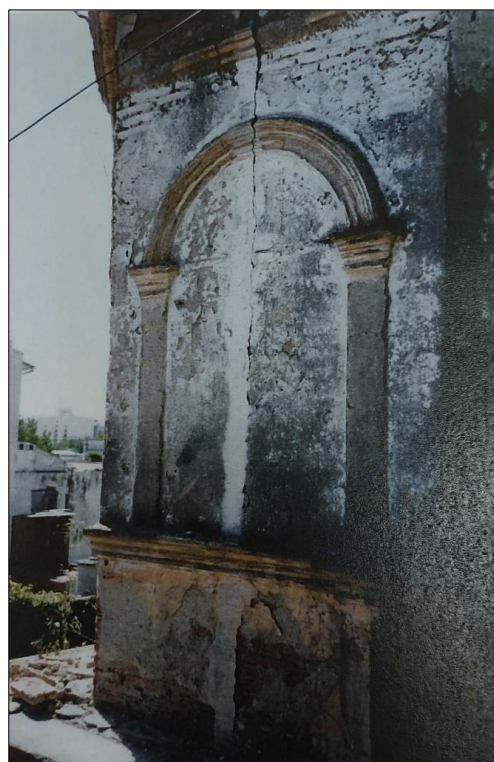
Figura 5. Vista externa de la torre mirador ubicada sobre parte superior de la casa. Fuente: Inmobiliaria Gómez Lama.
