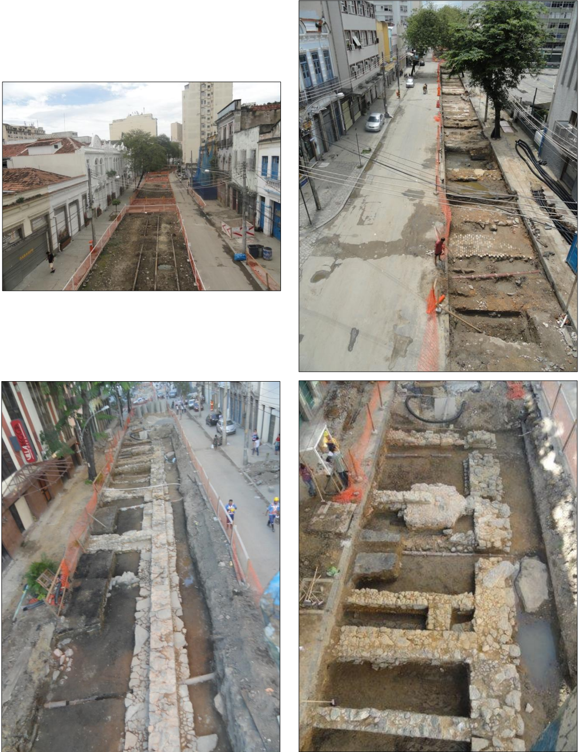
Figura 1. A rua Sacadura Cabral: a) já sem asfalto, antes de iniciados os trabalhos, e (b, c, d) em diferentes etapas de escavação dos trapiches. Fotografias: Studio Soma (2012).
