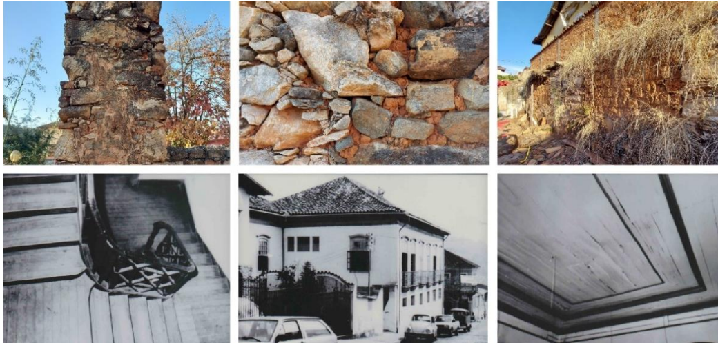
Figura 5. Acima: Detalhes das colunas e paredes em adobe e pedras emparelhadas. Fotografia: Caroline Ferreira, 2021. Abaixo: Alguns dos detalhes do interior e do exterior do sobrado fotografado por Almir Ferreira na década de 1990. Fonte: Foto Araújo.
